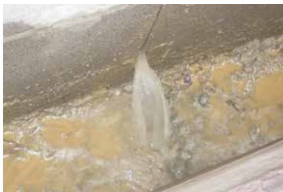
Obr. 2 - Netěsnosti konstrukce pod úrovní terénu
